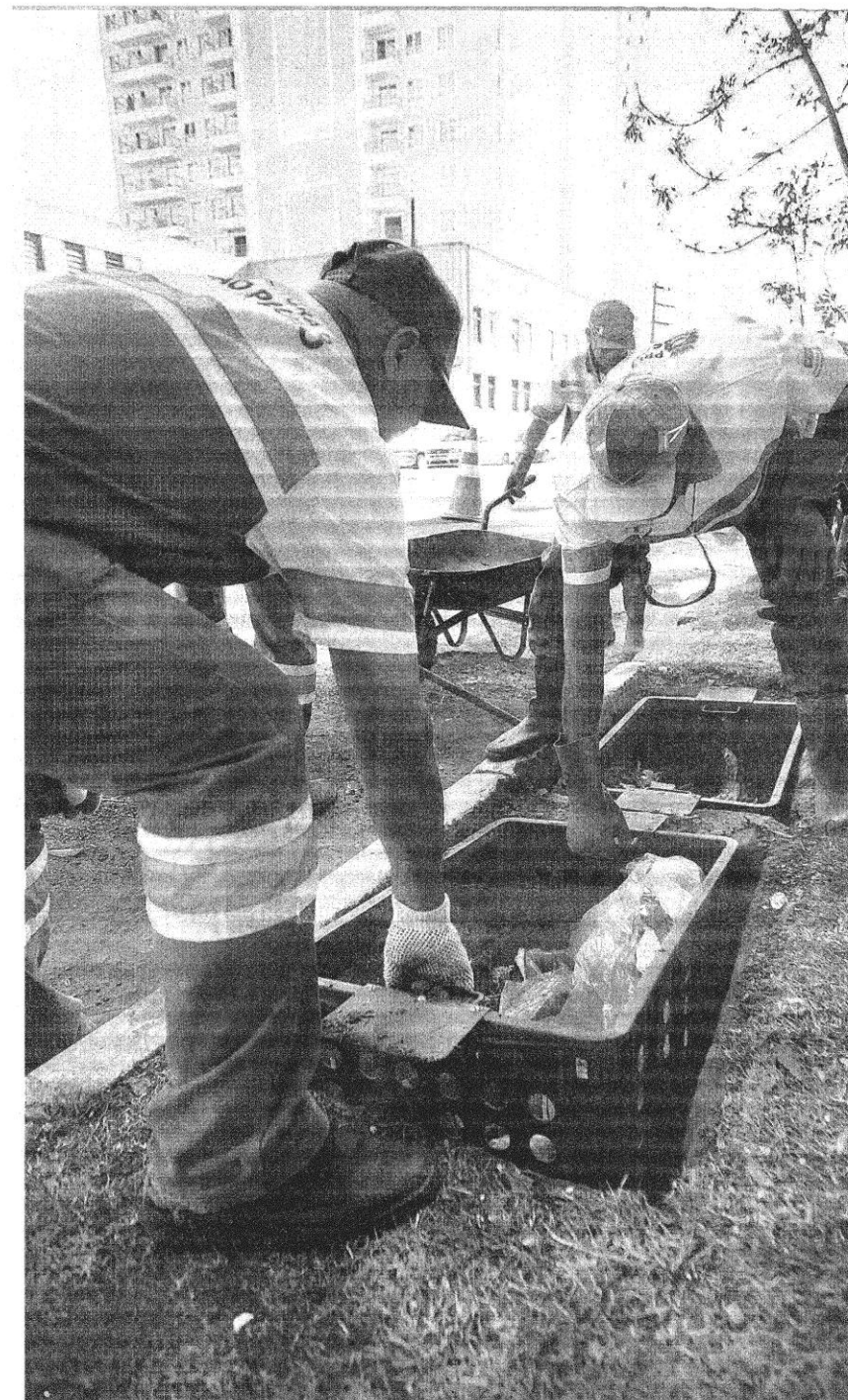
Funcionários recolhem cesto plástico que serve como filtro para bueiro em São Paulo
