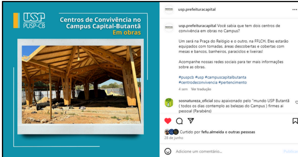
Figura 16. Centros de convivência em construção na FFLCH e na Praça do Relógio. Fonte: Instagram @usp.prefeituracapital
