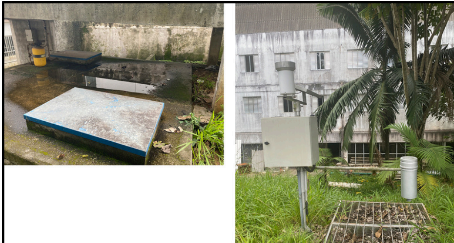
Imagem 1. Sistema de captação de água de chuva no CTH/Escola Politécnica. A água de chuva captada era utilizada nos banheiros porém, o sistema está inoperante devido a um problema na bomba. / Fotos: Fabiana Pegoraro Soares, 2024.
