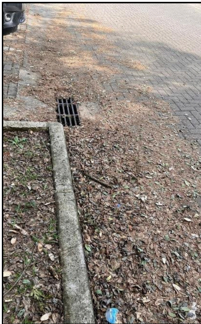
Imagem 25 Acúmulo de folhagem perto da boca de lobo
