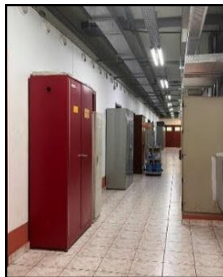
Imagem 66 Armários de armazenamento de RQ em corredores de passagem. IB
