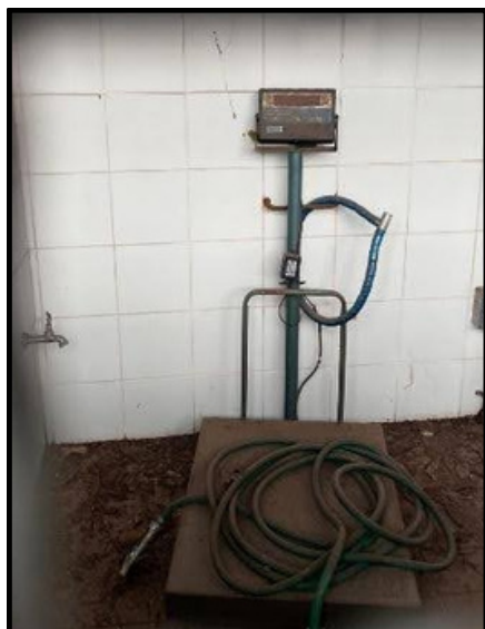
Imagem 112 Abrigo de RSS para coleta da Concessionária. Presença de balança quebrada.
